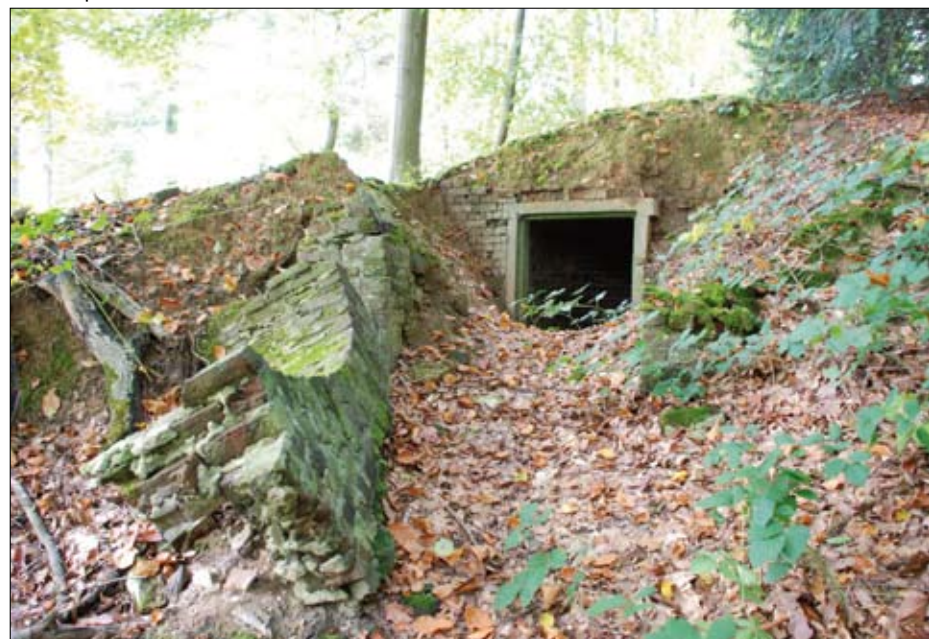
Figuur 3A: Zicht op de gedeeltelijk ingestorte ingang van de ijskelder in oktober 2008. © Ontwerpbureau Pauwels NV
