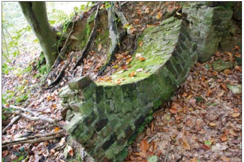
Figuur 3B: Detail van het onderdeel van het tongewelf van het ingestorte deel. © Ontwerpbureau Pauwels NV
